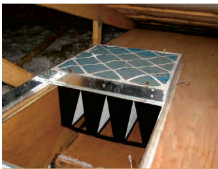
Caisson de filtre mécanique dans un entre-toit
