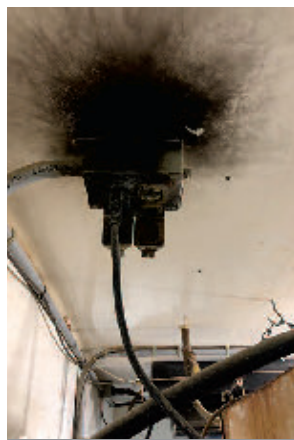
Début d'incendie en raison d'une surchauffe de la prise électrique causée par la corrosion.
